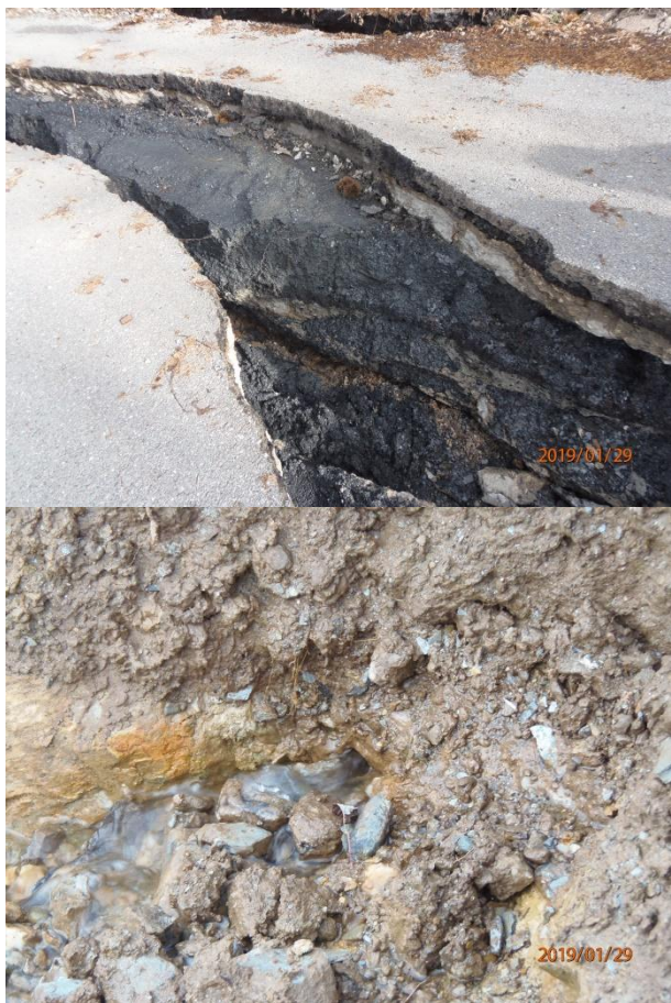
Εικ.8: Αστοχία κατάντη οδού Αλαγονίας Εικ.9: Εκφόρτιση πηγής επαφής οικισμού Μαχαλά
