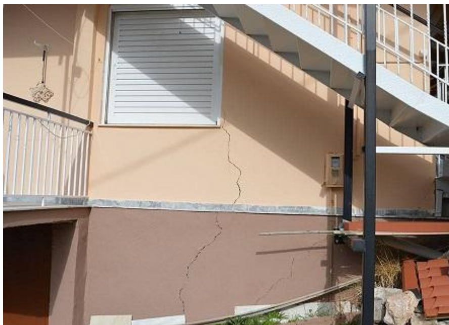
Εικ.6: Ρωγμές σε οικία στον οικισμό Αλαγονίας
