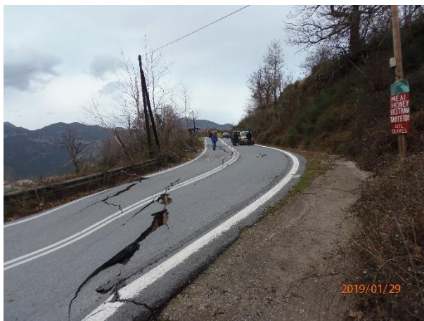
Εικ.2:Αστοχία οδού στη θέση 135
