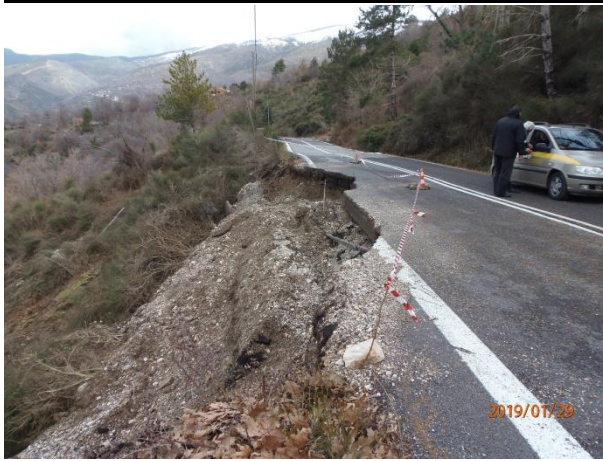
Εικ.4: Αστοχία οδού στη θέση 136
