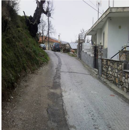
Εικ. 4 Αστοχίες στην οδοποιία στην περιοχή της Αλαγονίας
